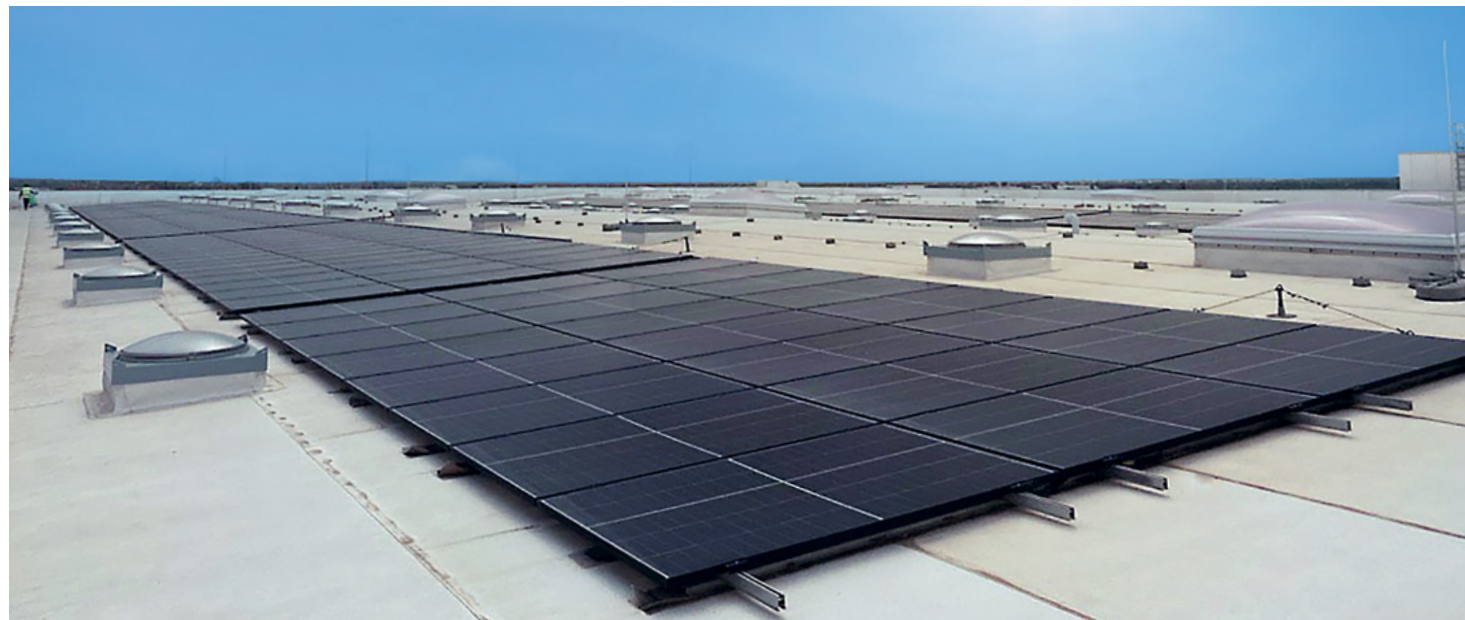
Aufdach-Photovoltaikanlage am Produktionsstandort in Jemmal, Tunesien.
